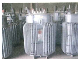
トランス（変圧器）
