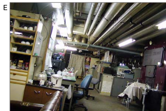
E どこにでもあるような地下機械室には石綿製品が溢れています。天井・壁の吹きつけ、そして多くの配管保温材や応急処理用の石綿パッキングや”ひも”は常に手に届くところに置かれていました。建物からの石綿ばく露も、劣化や破損に伴い起こり得ます。
