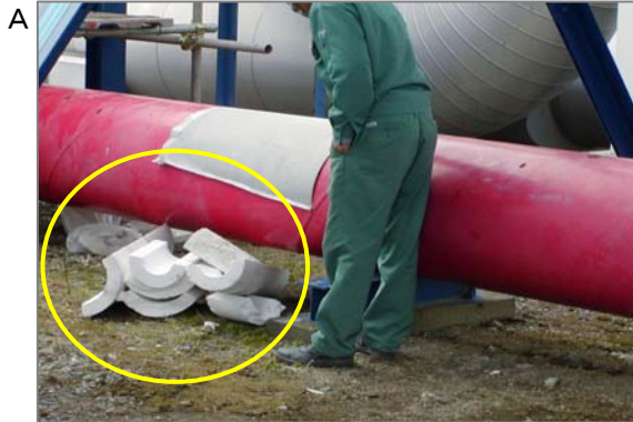
A 二つ割りのケイカル系石綿保温材。非常に軽く断熱性に優れていますが、もろくて飛散しやすいのが欠点。放置すれば自然劣化により飛散し、敷地を往来する労働者がばく露する可能性があります。
