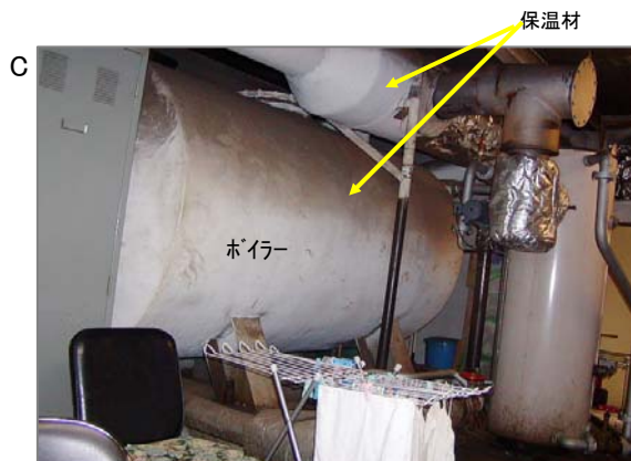
C ボイラー(お湯を沸かす装置)本体の全周囲に保温材が施工されています。そのボイラーから派生する管にも熱が冷めないように保温材が巻かれています。劣化・破損に注意。
